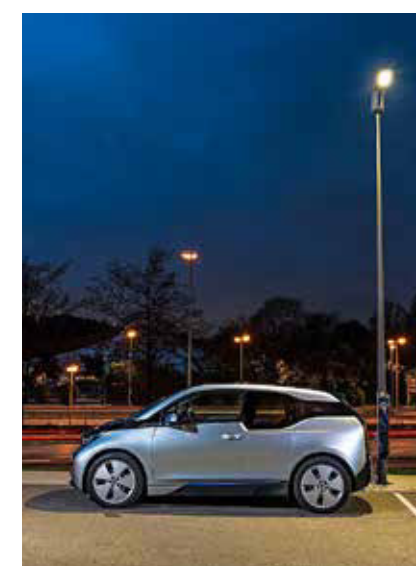
Doppelter Nutzen: LED Strassenleuchte als Ladestation für Elektroautos. Foto: BMW
